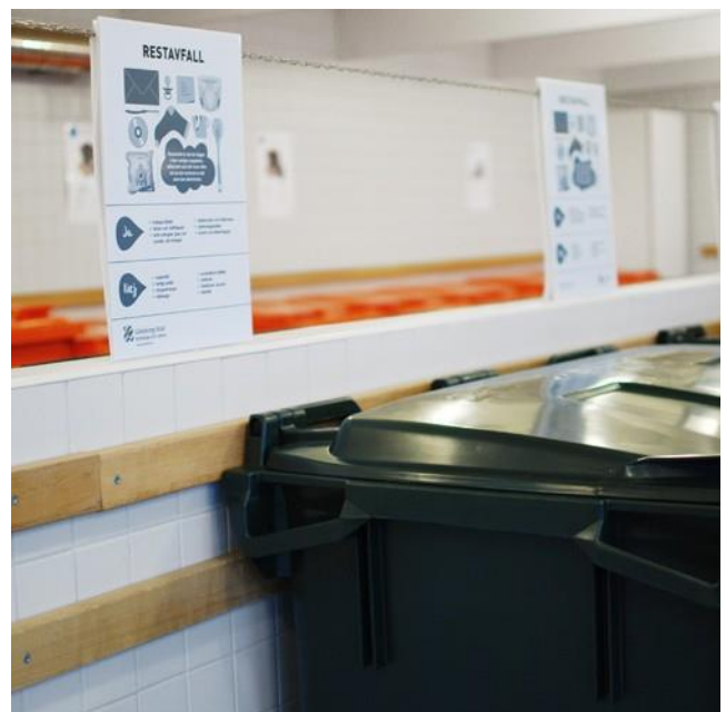
En avbärarlist skyddar väggen från stötar och slag.
