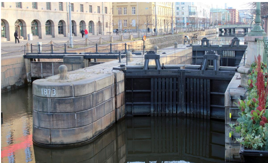
Figur 14. Befintliga "mitre gates" i slussen vid Drottningtorget i Göteborg. Foto Ross Carnegie.
