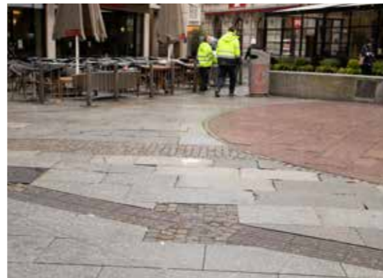
Tunga transporter i kombination med dåliga markförutsättningar och eventuellt för dålig överbyggnad har inneburit att golvet på många platser har gått sönder.
