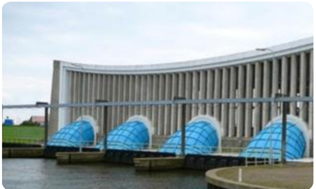
Figur 38. Exempel på en befintlig pumpstation, i Stavoren, Nederländerna. denna pumpstation har en kapacitet på 100 \text{ m}^3/\text{s} .
