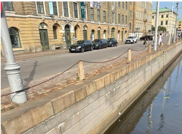
Figur 5. Del av kanalmuren som renoverades 2014 - 2015, uppströms den nu aktuella sträckan för renovering i Stora Hamnkanalen. Foto: Sweco.
