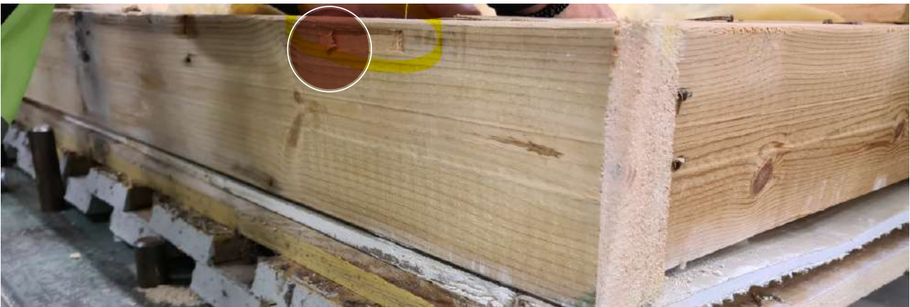
Figur 3. Riskställen för svampväxt, insida under syll.
