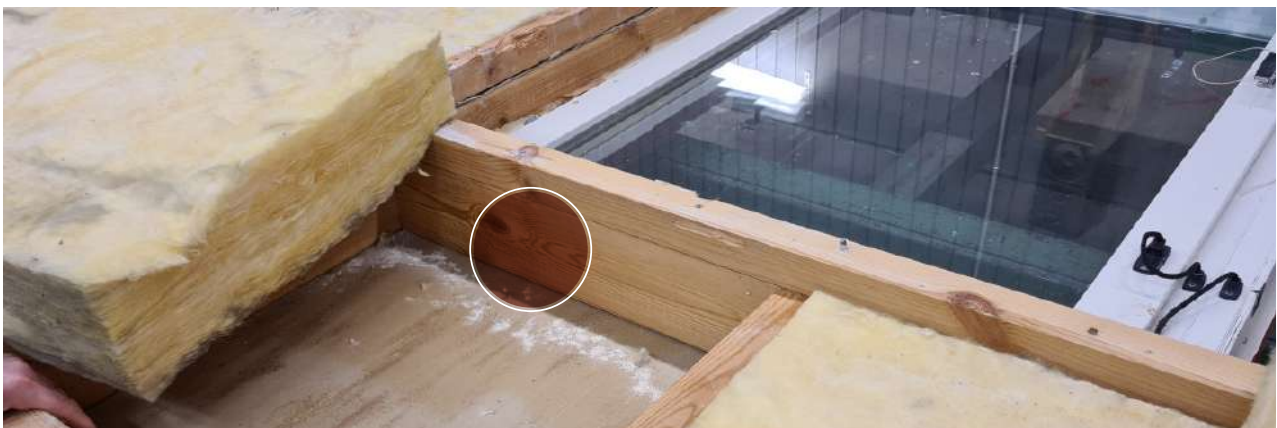
Figur 4. Riskställen för svampväxt, kortling under fönster.
