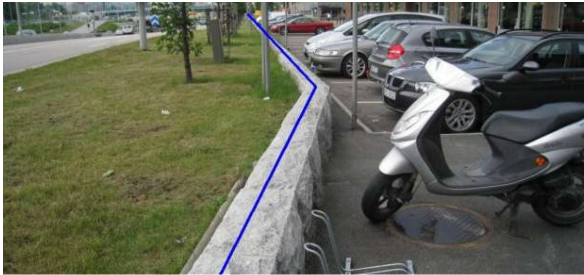
Figur 4 Den permanenta skyddsbarriären G2 för den östra infarten till Götatunneln i Göteborg. Bild: Trafikverket.
