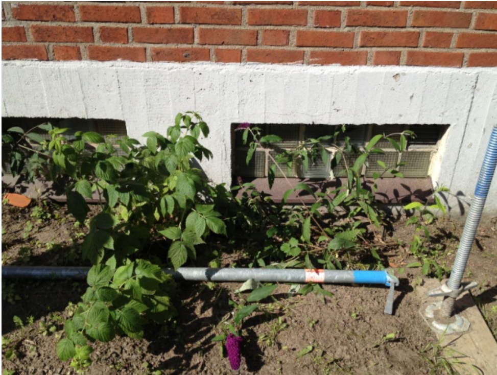
Figur 36, ett exempel på varför samordning behövs. En fjärilsrestaurang har blivit förstörd då renovering av skolans vägg utfördes. Foto: Emma Naqvi
