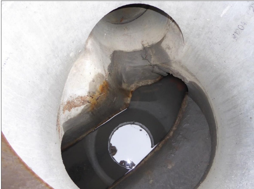
Figur 19. Inloppsanordning i brunn. Inloppet till dammen ligger i botten av brunnen. Vid sedimentrensning pluggas inloppet mot dammen och förbiledning sker då via brunnens bräddutlopp som ligger lite högre. Foto WRS
