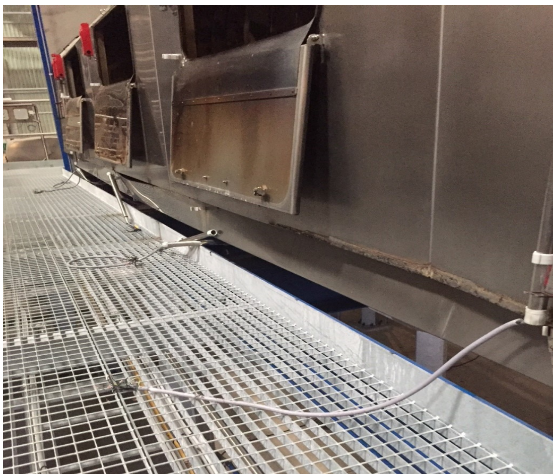
Figur 1. Losslitna elkablar efter explosion i skruvpress
