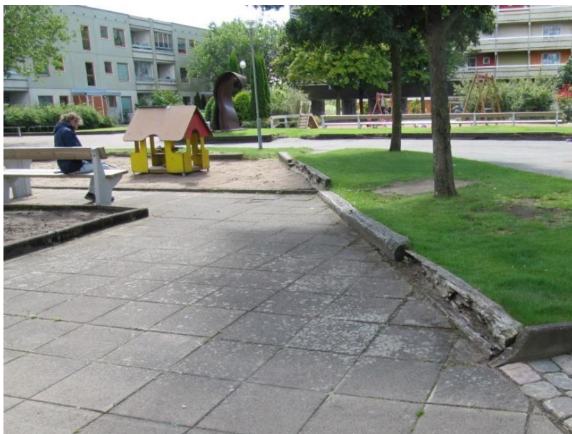
Fotografi visande en av Kastanjgårdens lekplatser med träkantstöd av slipers med rötskador.
