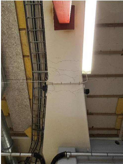
Bild 1, sprickor i pelare och takbalk.
