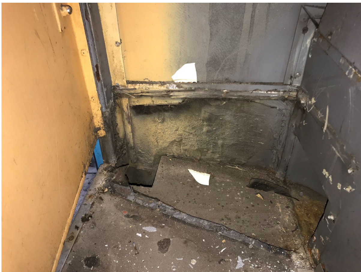
Figur 4 Ventilationskanal under rostfri sparkplåt akter om dörr 5
