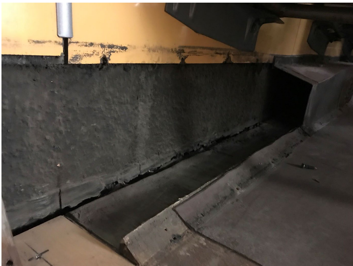
Figur 3 Ventilationskanal under rostfri sparkplåt
