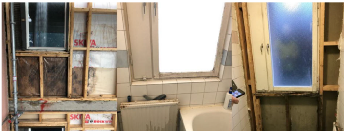
Foton från badrum som visar på stor fuktproblematik samt påväxt.
