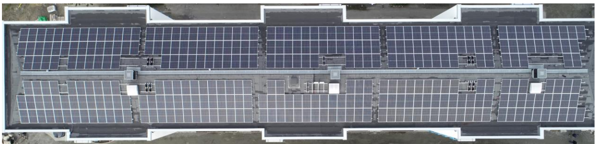
Drönarfoto på solceller installerade i den utvändiga renoveringen.
