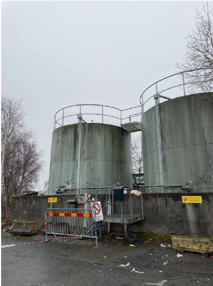
Figur 16. Två dieselcisterner utomhus. Tanken vänster i bild (södra tanken) är i bruk och cisternen till höger i bild (norra tanken) är tömd och sanerad.
