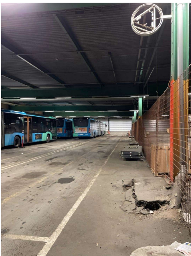
Figur 7. Fläckar på asfalten samt del av asfalt som har påverkats av sättningar
