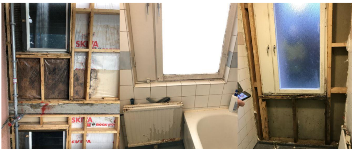
Figur 2 – Foton på vägg från ställning samt inifrån badrum i anslutning till yttervägg
