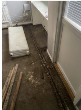
Vattenskadat vardagsrum p g av ledningsläckage.
