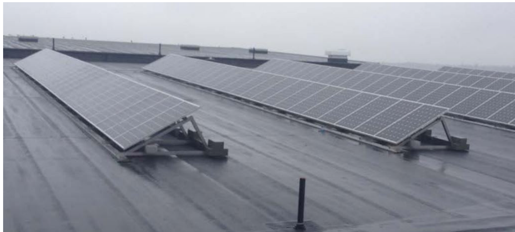
ERFARENHETER FRÅN MEDELSTORA SOLCELLSINSTALLATIONER PÅ BYGGNADER, ENERGIFORSK AB 2015
