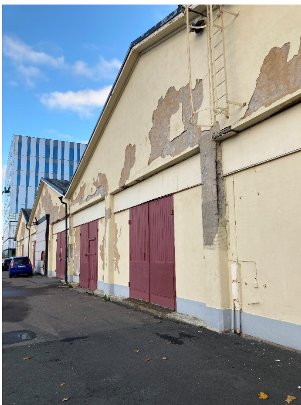
Figur 3 Fasad på Magasin D som behöver åtgärdas.
