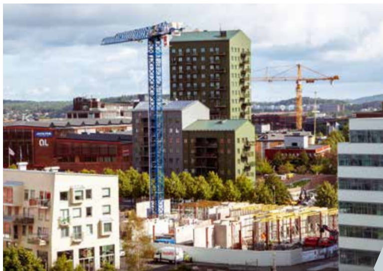
I konsortiet för Lindholmshamnen ingår HSB, PEAB, Riksbyggen, Skanska och Älvstranden Utveckling.
