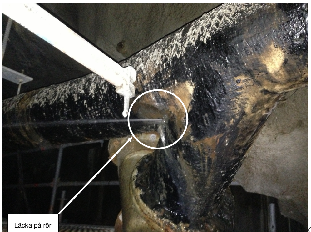
Figur 1. Läcka på rör, Röda Sten 2015
