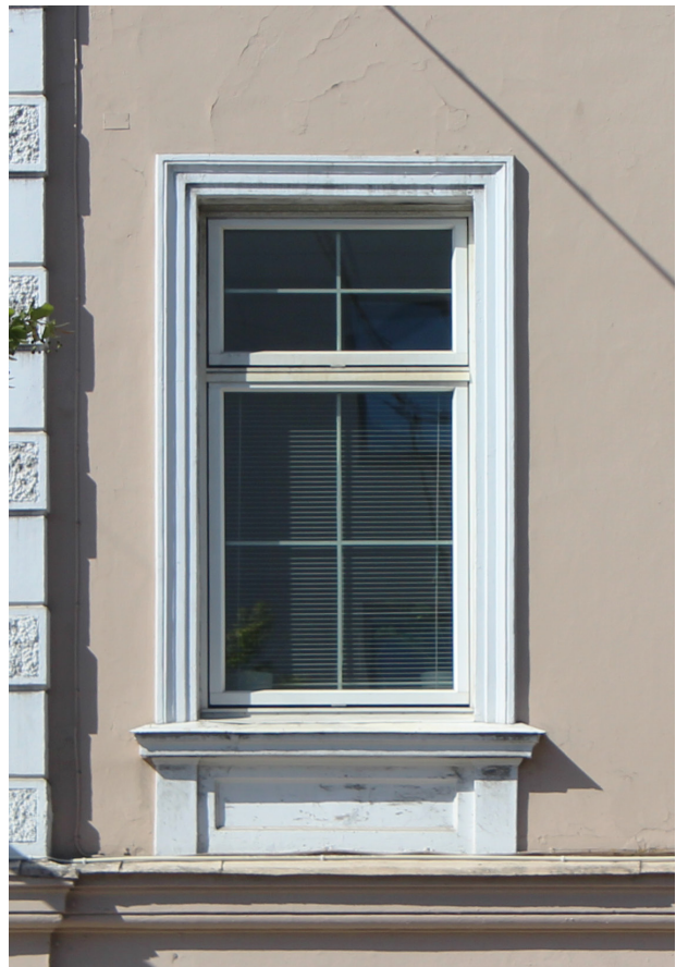
Falsk spröjs i utformning utan historisk förlaga i ett fönster på en byggnad från 1870-tal.
