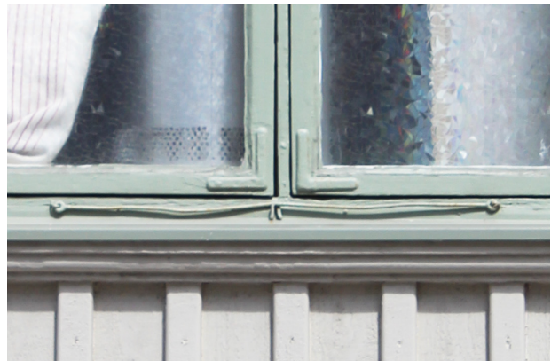
Hornjärn och stormhakar på fönster från 1930-tal.
