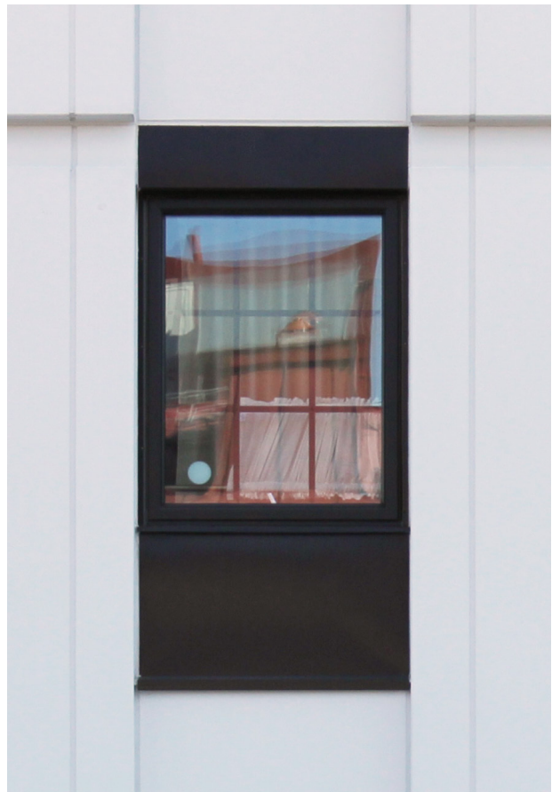
Falsk spröjs på insidan av fönster i 70-talsbyggnad, som ursprungligen varit ospröjat.
