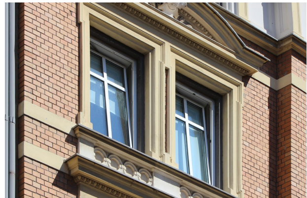
Fönster där fyra lufter istället blivit en.
