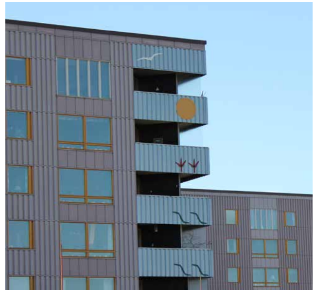
Bostadsrättsföreningen Masthuggets balkonger mot älven innan de byttes ut.
