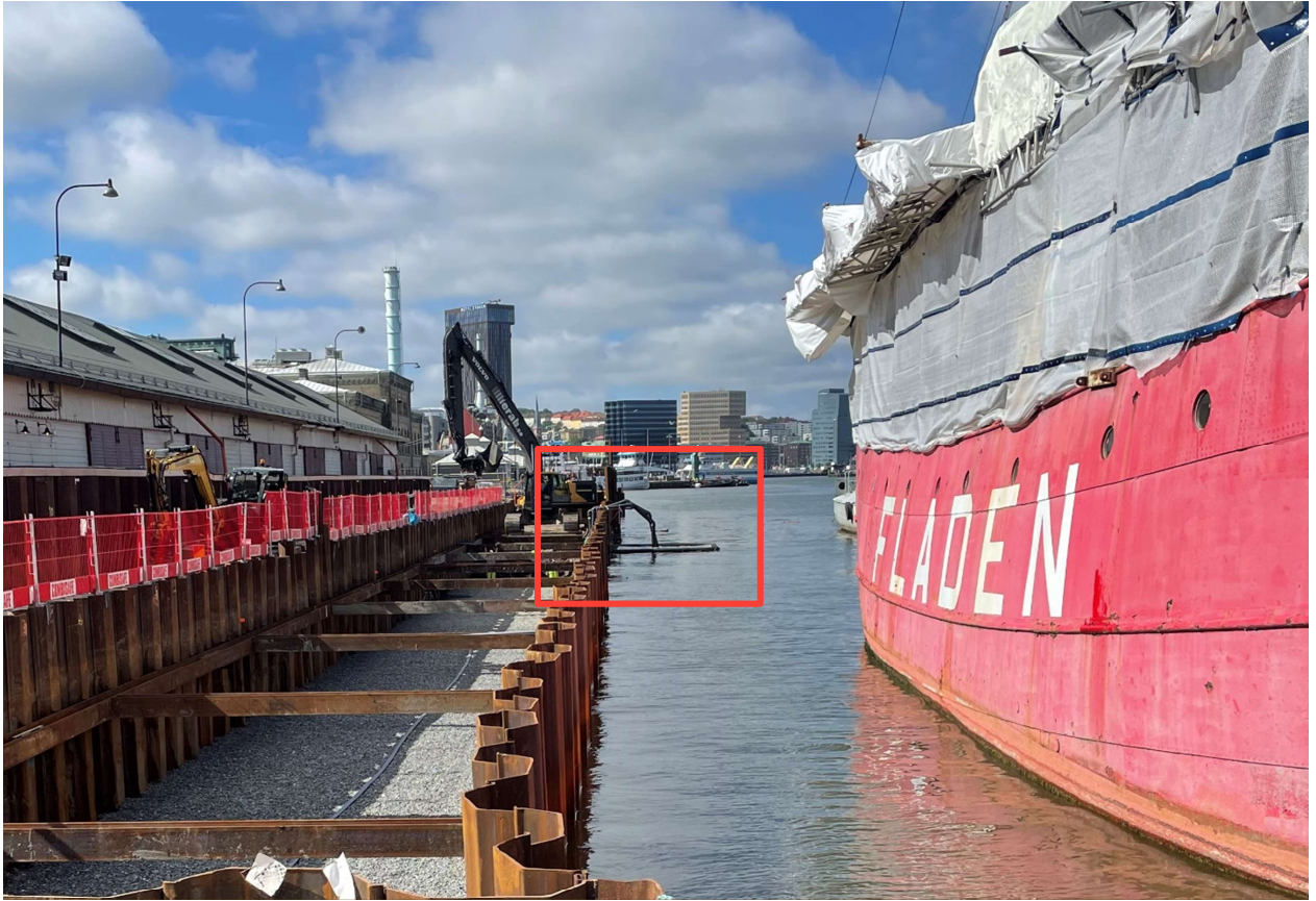
Figur 9. Bild på siltratt i drift under arbetet med pågående etapp. Siltratten är markerad i rött. WSP, 2022.
