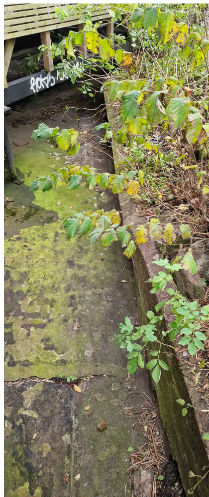
Figur 21. Objekt 4 sedd snett ovanifrån. Jordtrycket från de överliggande massorna trycker ut betongsargen. Mot syd.
