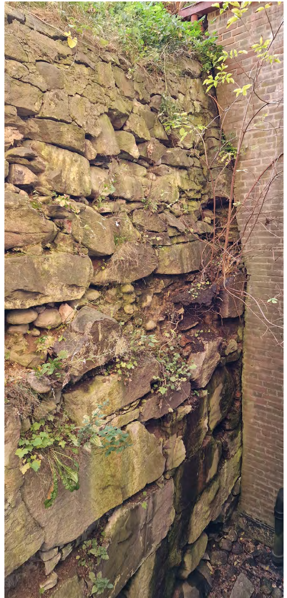
Figur 11. Objekt 1 gråstensmur som har varit restaurerad med cementbruk. Med tiden har bruket vitrat och spolats bort. I murens övre del finns spruckna rester av bruket kvar. Mot sydsydöst.
