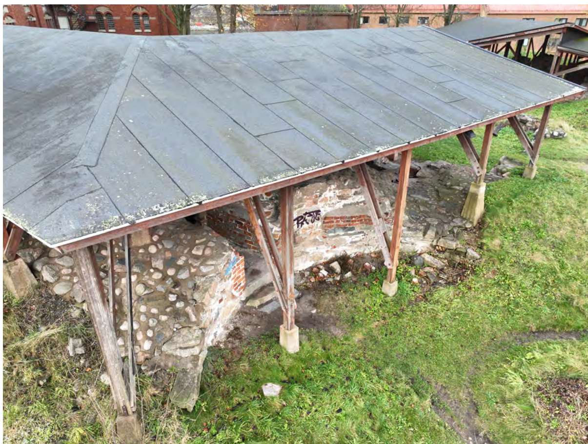
Figur 64. Foto från drönare. Bild av rester från slottets sydöstra torn. Murytorna utanför taket är påverkade av frostsprängning och vegetation. Några stenar har sprängts ur muren av rötter. Mot nordväst.
