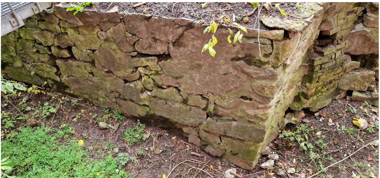
Figur 18. Terrasmuren förefaller stabil men flera stenar har lossnat och bruket släpper ur fogarna. Mot sydväst.
